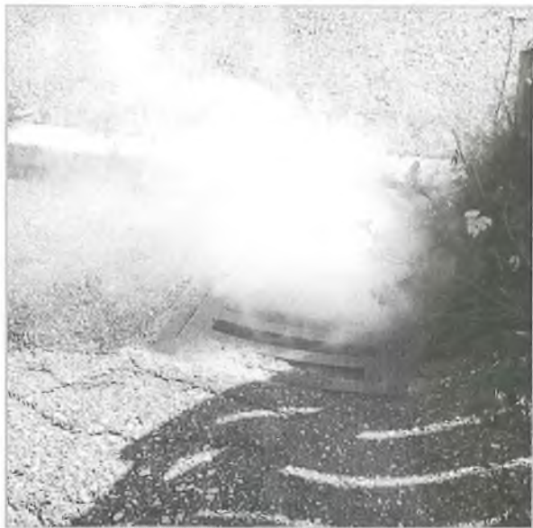
Durch Rauchproben kann jede falsche Verbindung mit dem Schmutzwasserkanal festgestellt werden
