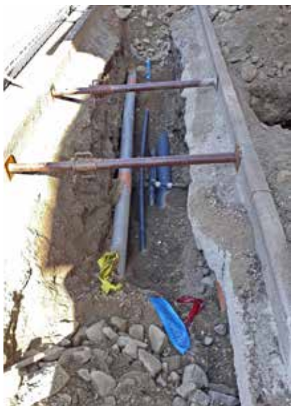
Im Zuge der Verlegung der Stromleitung in Steinhaus wurde gleichzeitig ein Teilstück der bestehenden alten Wasserleitung ausgetauscht
