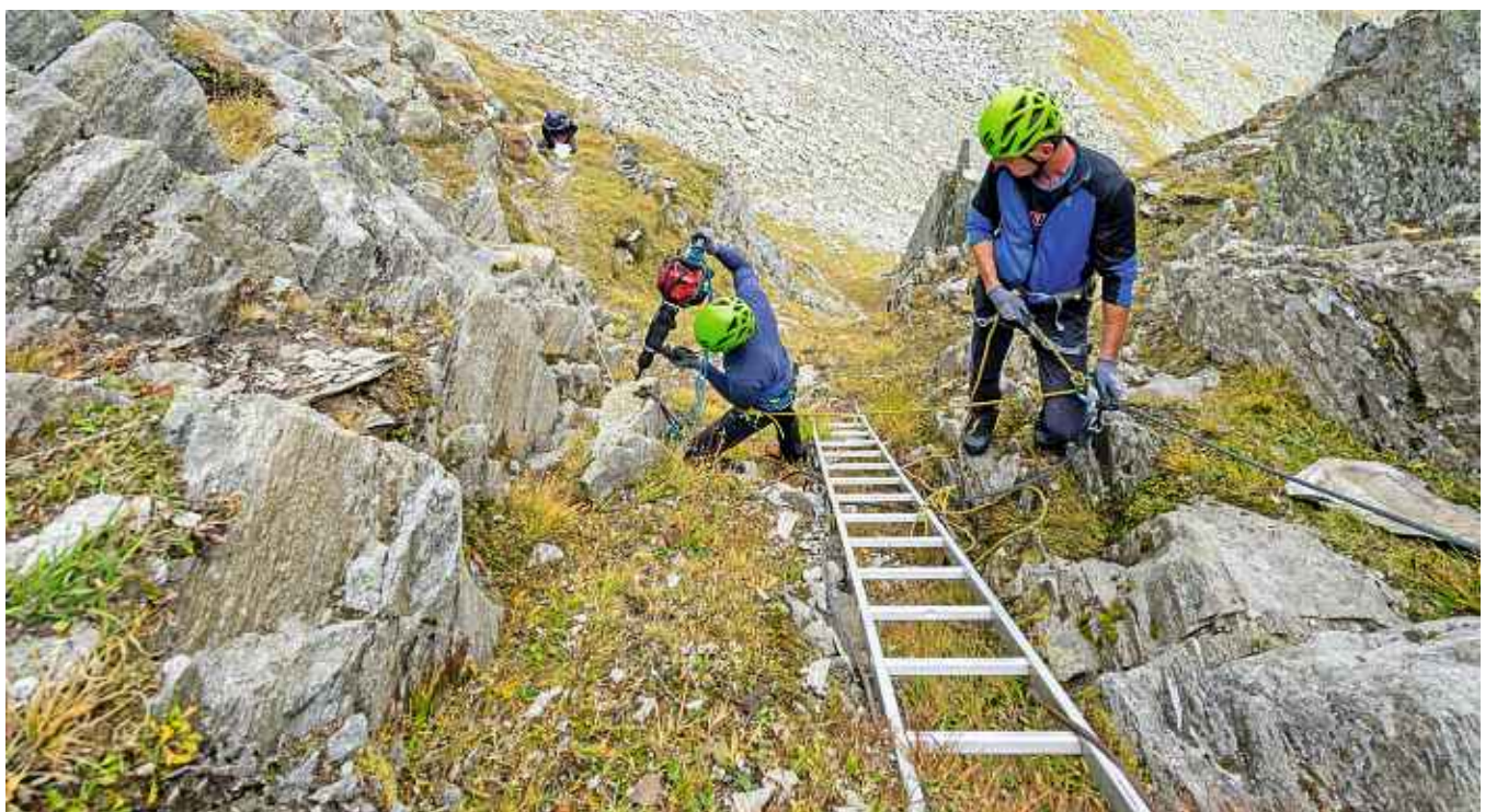
Am Lausitzer Höhenweg wurden eine neue Leiter und 100 m neues Seil montiert
